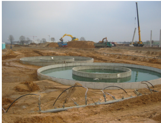
Mit Wasser gefüllte Sprinklertanks für Lagerhallen in der Bauphase-selbst für diese wird schon so vorgesorgt, dass Wasser vorhanden ist!
